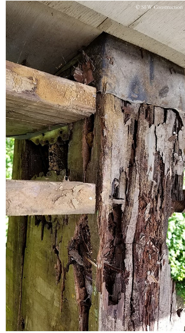
TROCKENFÄULE DRY ROT (Fungal decay)
